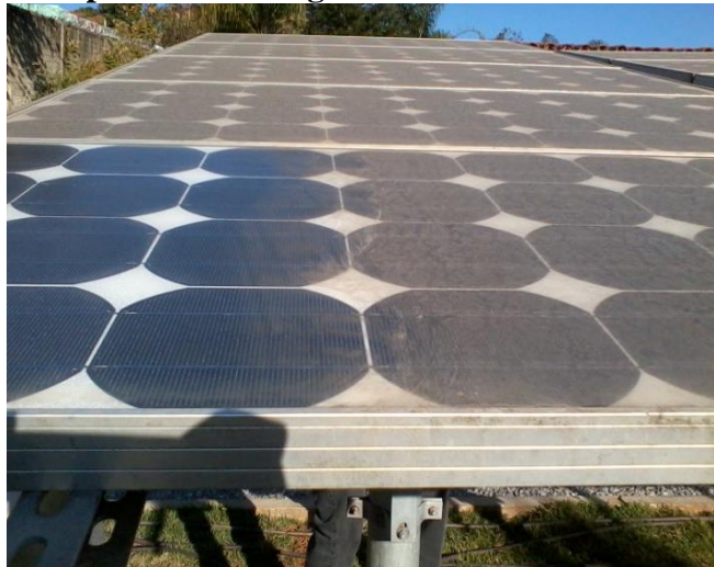
Figura 28: Camada de poeira sobre o gerador fotovoltaico CEMIG-São Gabriel
